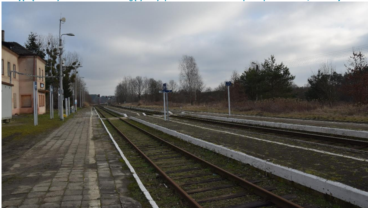
Rysunek 18. Zdjęcie ze stacji Lubicz przedstawiające niskie perony (niedostosowane do obecnych standardów), które cechują się znacznymi nierównościami mogącymi być problemem dla osób z niepełnosprawnościami, linia kolejowa nr 27
